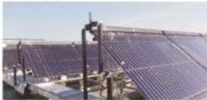
Реализация системы по производству тепловой энергии путем освоения возобновляемых источников тепловой энергии в административном и вспомогательном Комплексах Мангалия, Румыния
