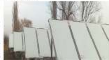
Система по производству тепловой энергии с помощью возобновляемых источников тепловой энергии в Национальном Колледже для девочек "Благовещение" Брашов, Румыния
